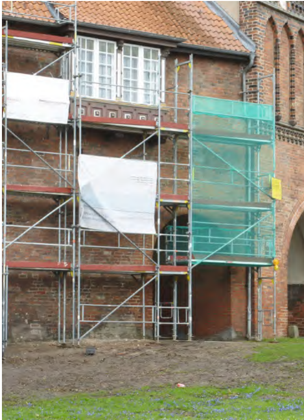
Abb. 6 Vom Gerüst erfolgte die genaue Untersuchung der Schäden und ihrer Ursachen, unabdingbare Voraussetzung für eine denkmalgerechte Instandsetzung – HLk/Abt. Denkmalpflege/Knipscheer..
