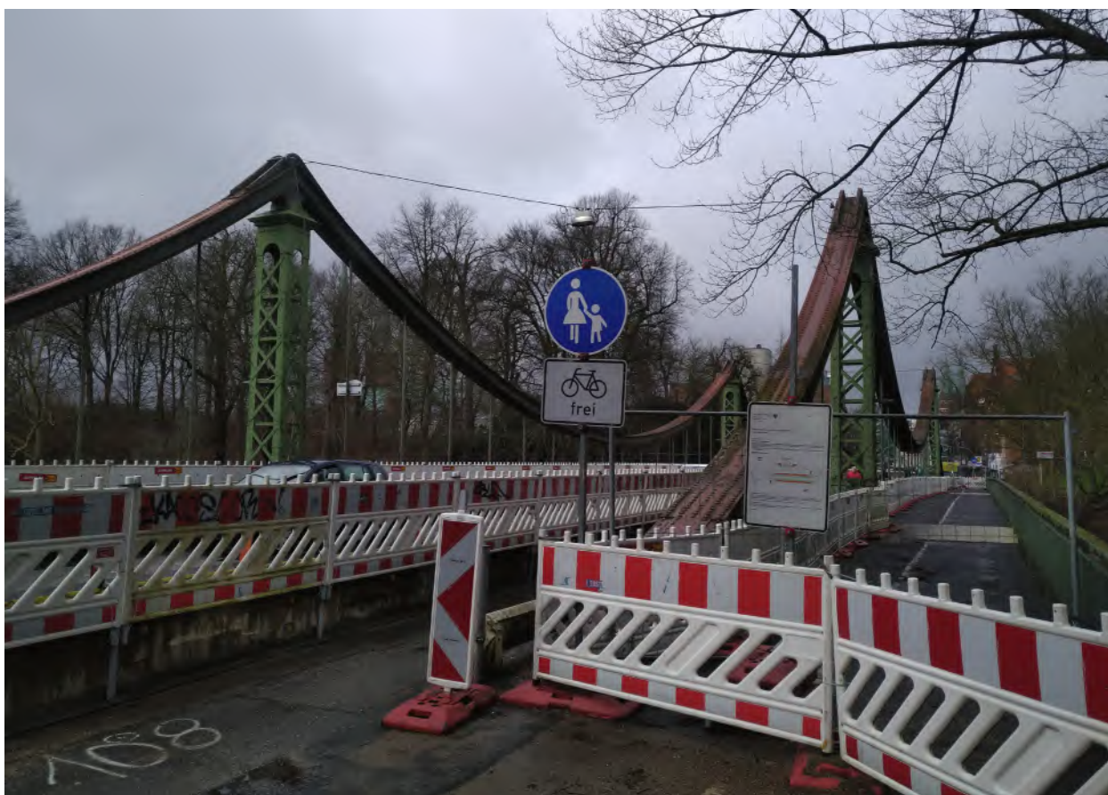
Abb. 4 Notwendig gewordene Absperrungen schränken die Nutzung der Brücke stark ein – HL/Abt. Denkmalpflege/ U. Köhn.
