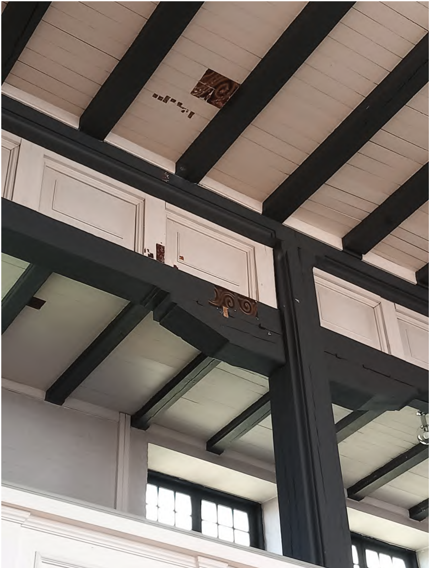
Abb. 2 Hansestadt Lübeck, St. Johannes in Kücknitz, Malereibefund an der Balkendecke und der Empore, 2023 – HL /Abt. Denkmalpflege/Lutter.
